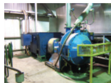
Un raffineur neuf installé en 2006
